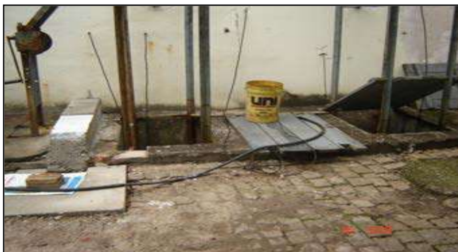
Figura 11 - Chegada do efluente na ETE (Fonte STE)
