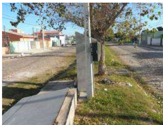
Quadro de comando ELE – Fátima. (Fonte SANEP)
