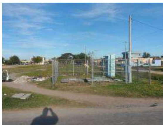
Quadro de comando ELE – Meneghetti. . (Fonte SANEP)
