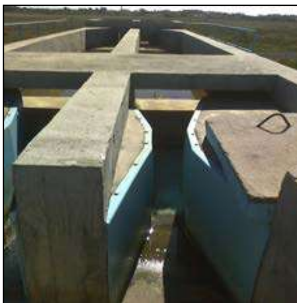
Figura 27 - Calhas Parshall (Fonte STE)
