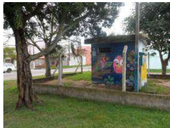
Quadro de comando ELE – Umuharama. (Fonte SANEP)
