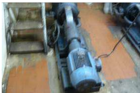
Motores Elevatória Saldanha Marinho US-II . (Fonte STE)
