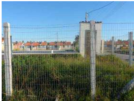
Quadro de comando ELE – Eldorado. (Fonte SANEP)
