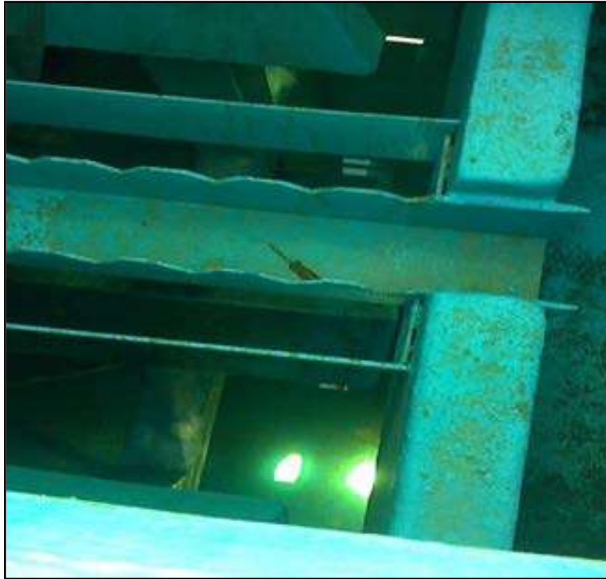
Figura 30 - Calhas internas dos reatores (Fonte STE)
