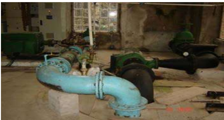
Ilustração 13 - Motores, bombas, tubulação e poço de sucção
