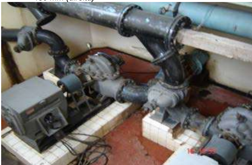
Ilustração 18 - Vista dos conjuntos motobomba 300 mm
