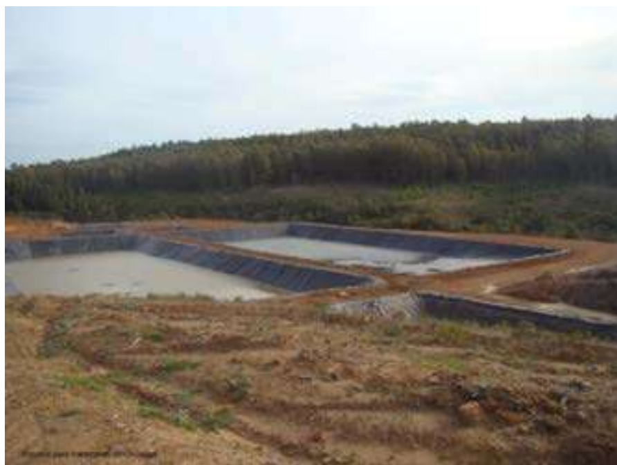
Figura 3.43 – Lagoas de estabilização para tratamento dos lixiviados
