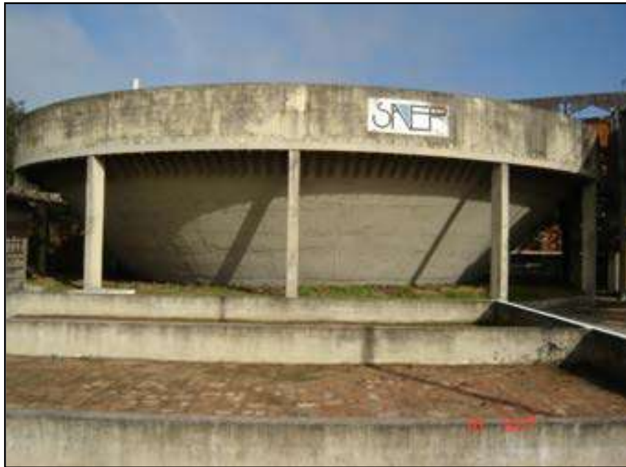
Figura 16 - Vista de um dos reatores (Fonte STE)
