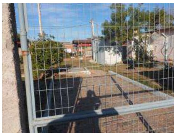
Quadro de comando ELE – Navegantes. (Fonte SANEP)
