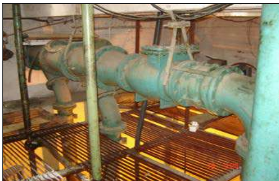
Figura 13 - Barrilete de recalque (Fonte STE)
