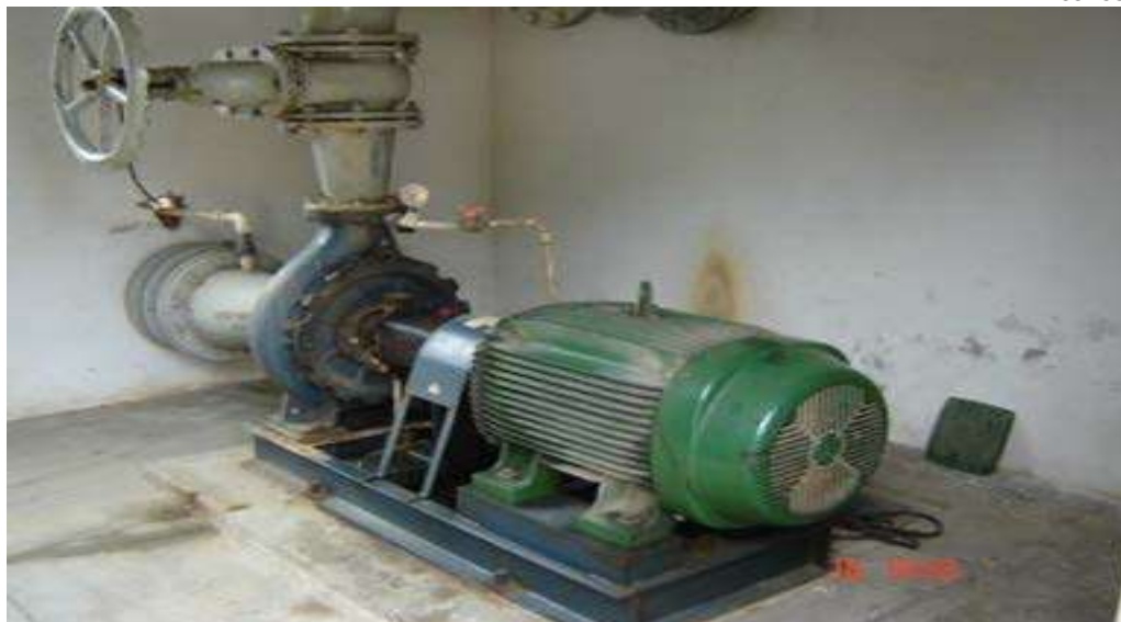
Ilustração 29 - Conjunto motobomba 1ª EEAT
