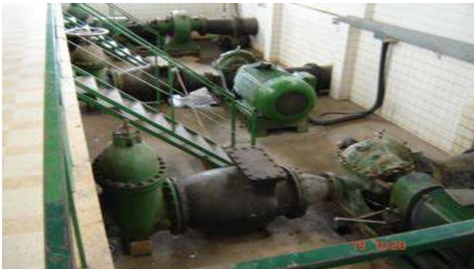
Ilustração 48 - Vista parcial da casa de bombas
