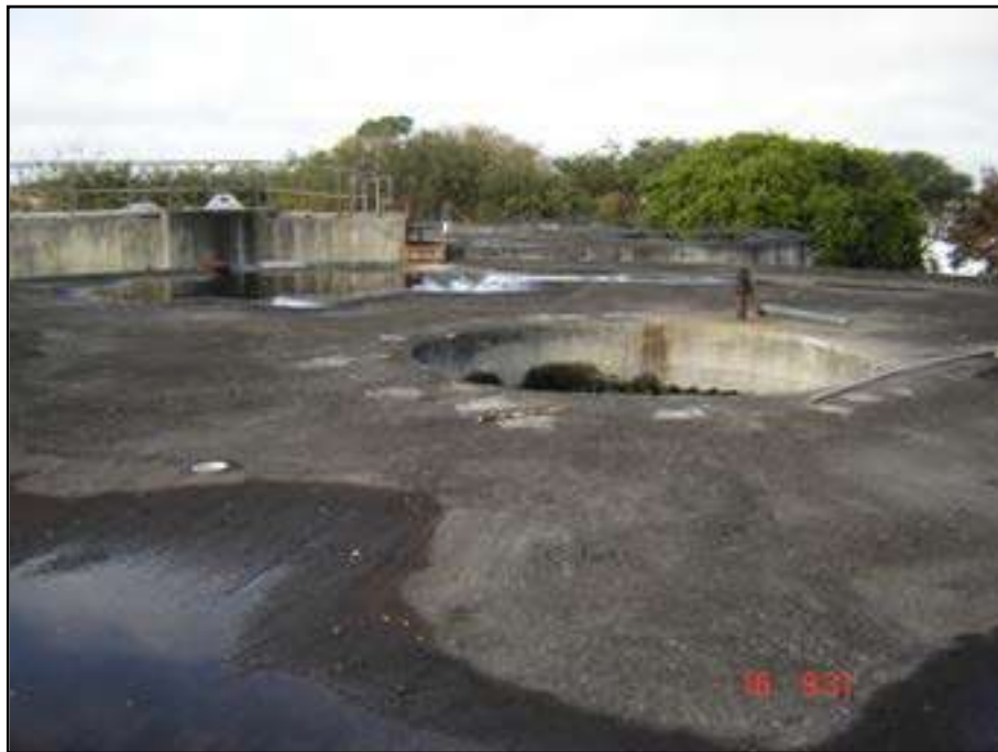
Figura 19 - Vista superior dos reatores (Fonte STE)
