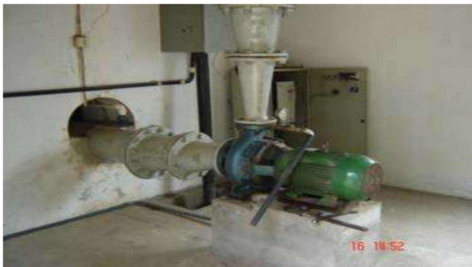
Ilustração 30 - Conjunto motobomba 2ª EEAT
