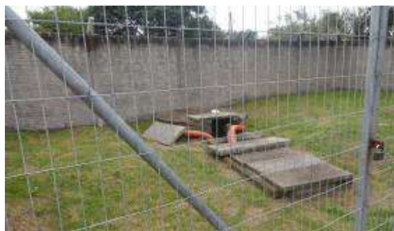
Local da Elevatória Cohab Lindóia. (Fonte SANEP)
