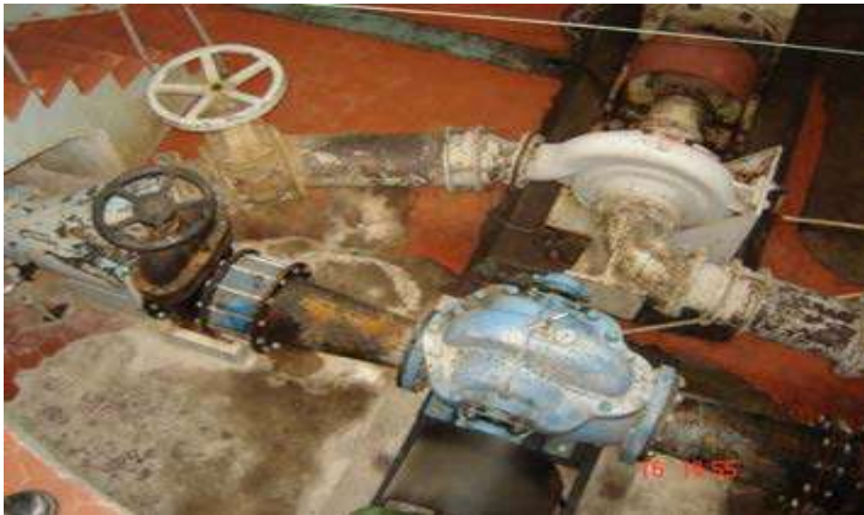
Ilustração 31 - Conjunto motobomba 3ª EEAT
