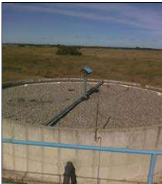
Figura 32 - Vista superior do filtro biológico (Fonte STE)
