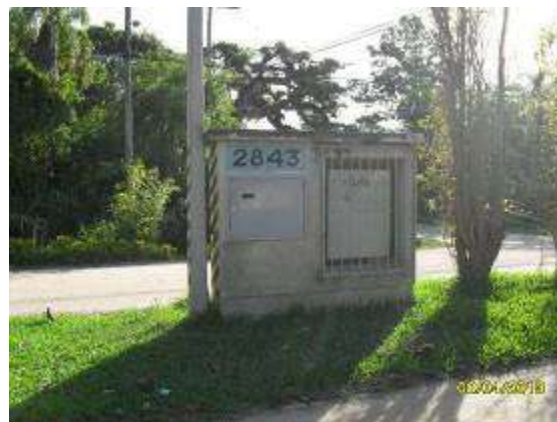
Quadro de comando ELE - L2. (Fonte SANEP)
