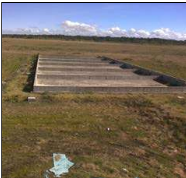
Figura 33 - Leitos de secagem de lodo (Fonte STE)
