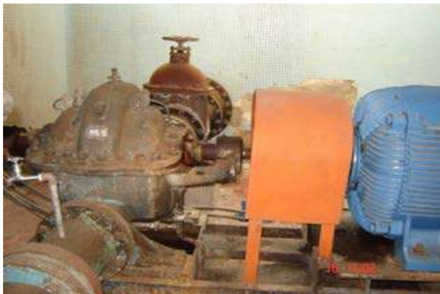
Ilustração 32- Conjunto motobomba 4ª EEAT
