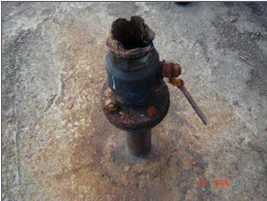
Figura 21 - Queimador de gás desativado (Fonte STE)
